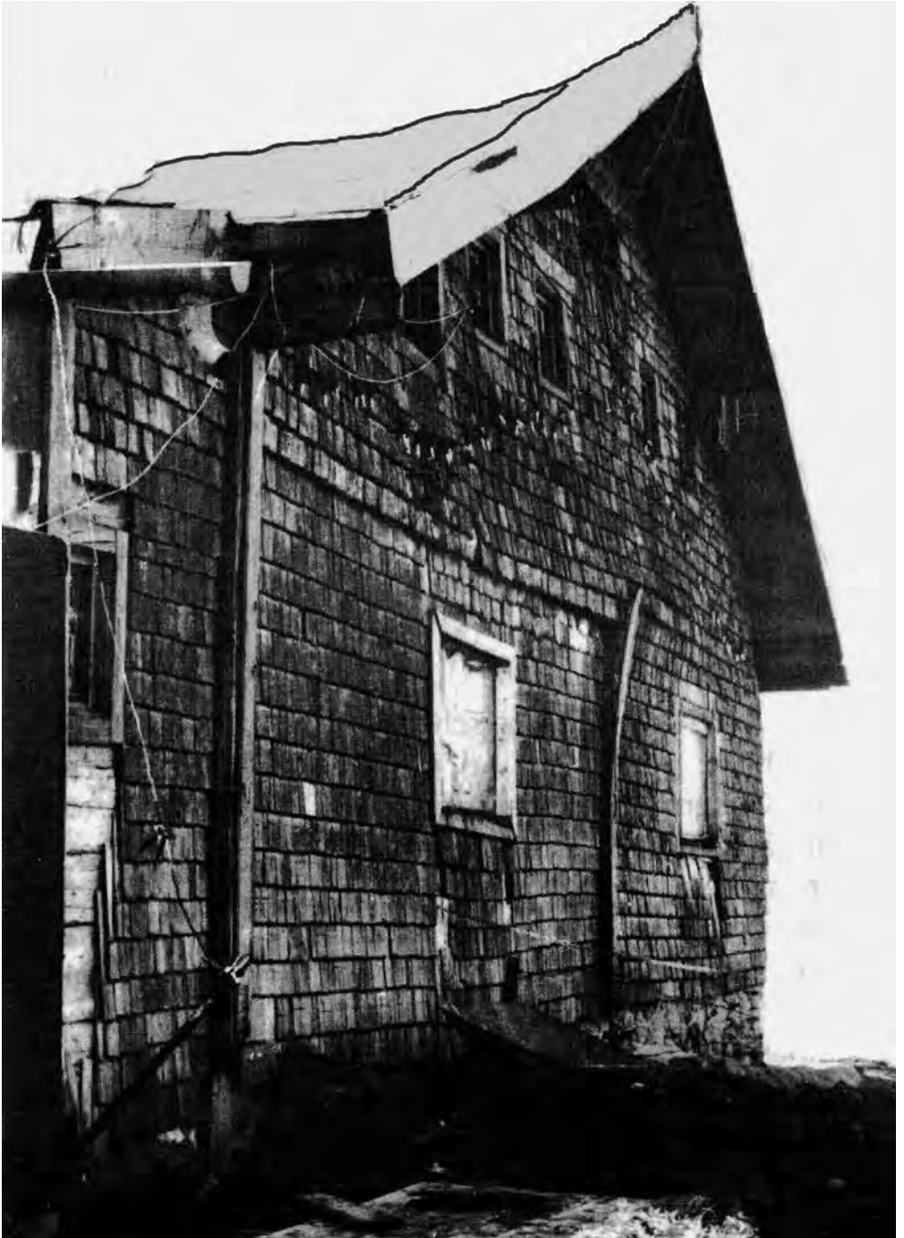
Die abbruchreife Hochrieshütte aus den 30er Jahren – Nordseite
